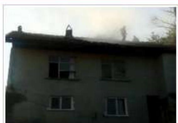
15:10 - Kastamonu'da Üç Katlı Betonarme Bina Yandı Kastamonu'da üç katlı betonarme bina yanarak kullanılamaz hale geldi...
